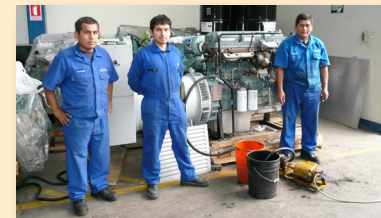
▲ Tres hombres de Detroit Diesel trabajan en el generador de emergencia.
